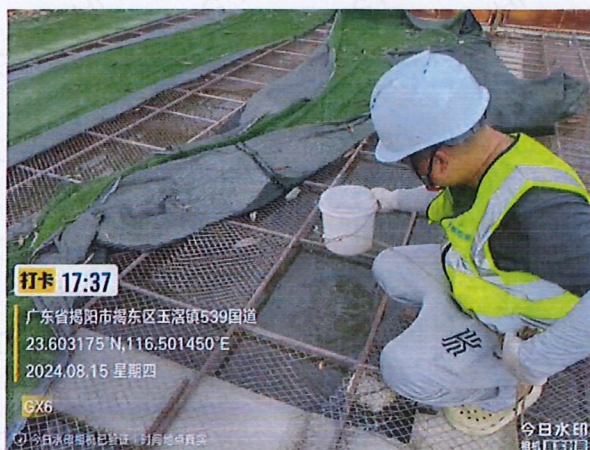
施工 3 标 GX6 生产废水
