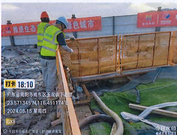
施工 2 标 GX8 生产废水
