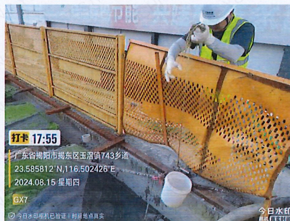
施工 2 标 GX7 生产废水
