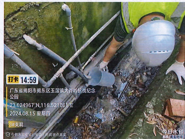
施工 1 标 3#支洞厨房生活污水
