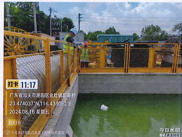
施工 4 标 GX16 生产废水
