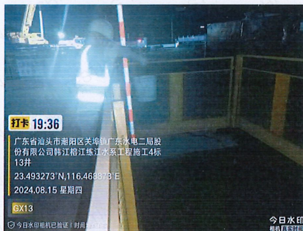
施工 4 标 GX13 生产废水
