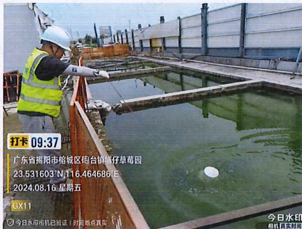
施工 3 标 GX11 生产废水
