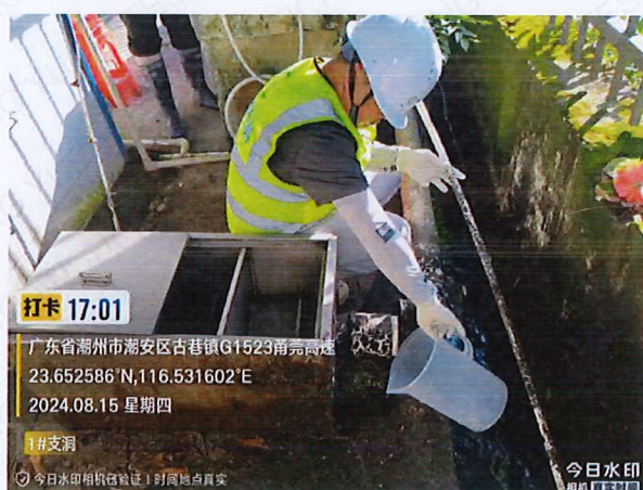
施工 1 标 1#支洞厨房生活污水
