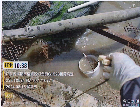
施工 2 标 GX12 生产废水
